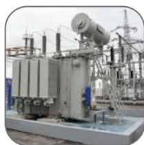
Объекты энергетической отрасли
